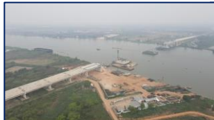
*Jembatan Musi, Sumatera Selatan
